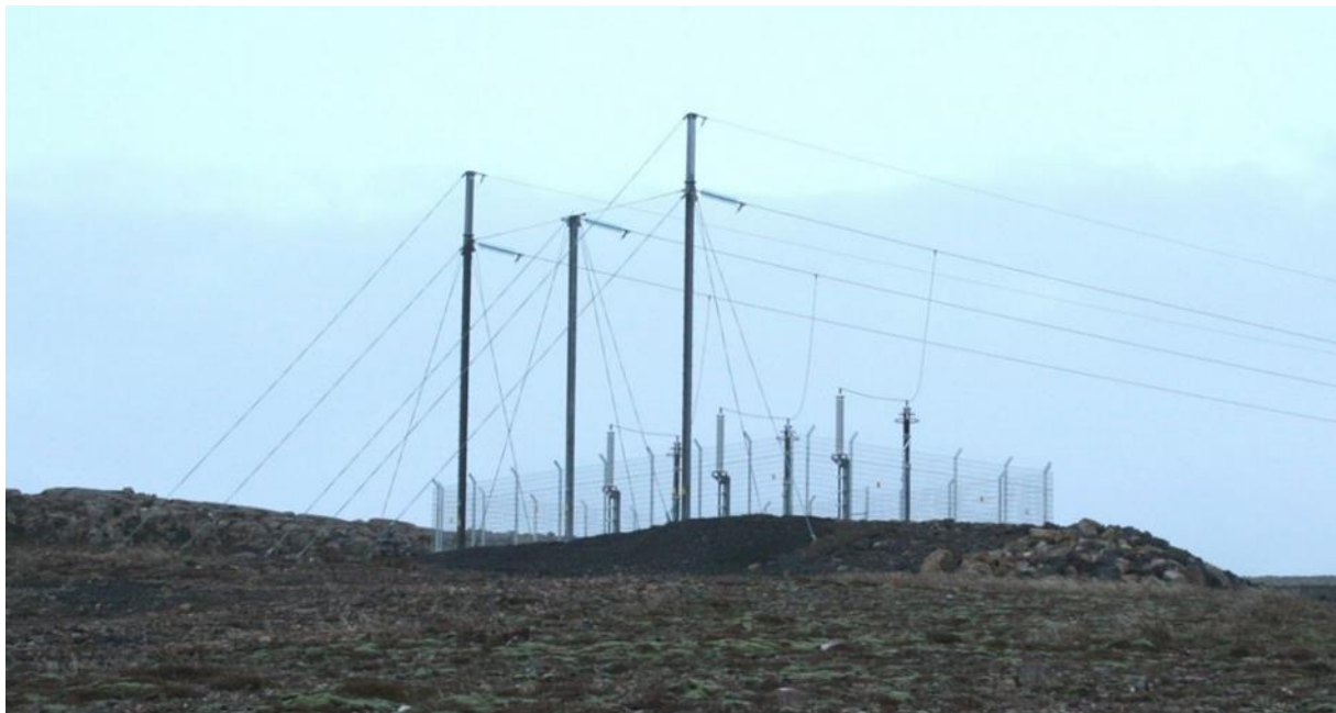
Mynd 6.8. Endavirki fyrir 132 kV jarðstreng (eitt strengjasett) í Hnoðraholtslínu 1. Efst eru jarðvívar til að verjast eldingum. Endavirkin í Blöndulínu 3 þyrftu að vera talsvert umfangsmeiri, þar sem um er að ræða 220 kV jarðstreng.
